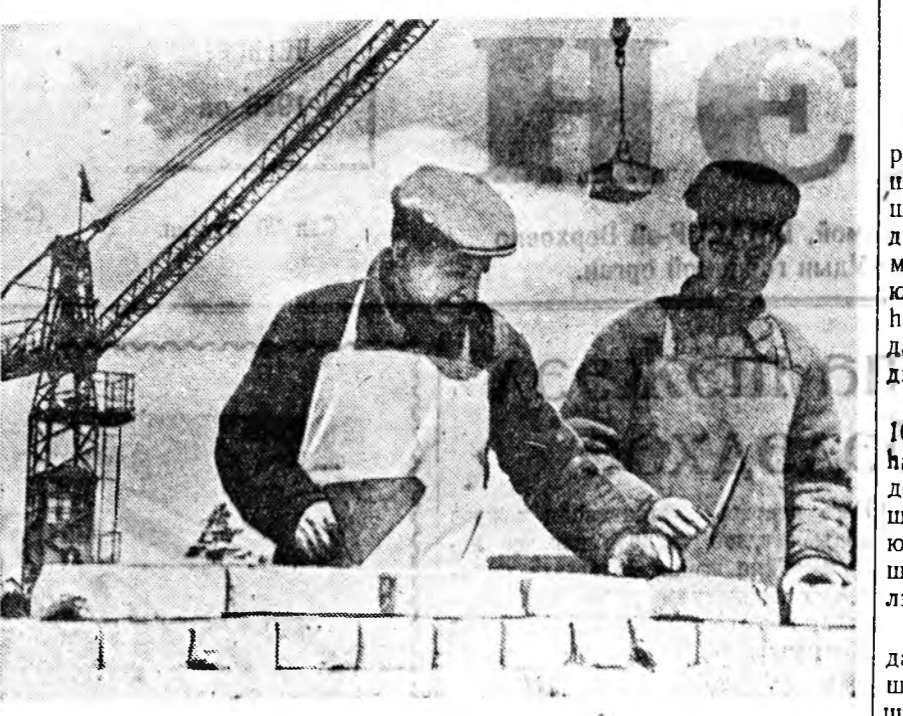
Зөөгөнтөгидэй студентүүдэй хорооногье барилга дээр ажалладаг Ф. Мартыновай бригада ехэшгэ ажалта туйлаа. Энэ бригадын гэшүүд үдэр бүри хоёр — хоёрһоо дээш даалгавари дүүргэнэ.
