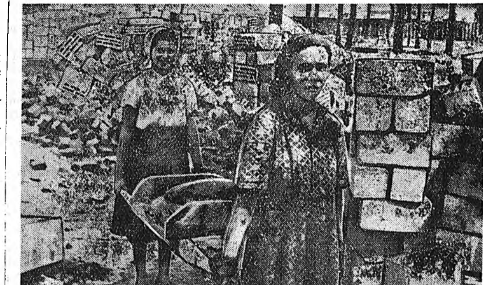
Түмэр замай барилгашад ПБЗ-гэй хүдэлмэришэдй хүүгэдэй сад барижа ажилбэ. Барилгашад Б. Лаврентьева, В. Астанцева гэгшэд гэр байра олоор бариха тухай парти, правительствынгаа тогтоолдо харюу болгон, халаан бүхэнднэгөө нормые 150 процент хүртээр дүүргэнэ. ЗУРАГ ДЭЭРЭ: нүхэд Лаврентьева, Астанцева хоёр ажаллажа байна. В. Хомутниковай фото.
