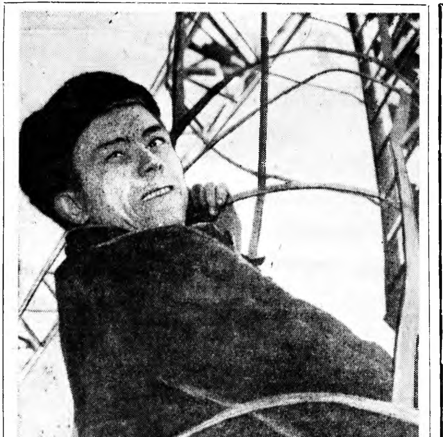
ЗУРАГ ДЭЭРЭ: башенна кранай машинист Иван Городецкий. Энэ хүмийн Хорин «СМУ-2» предприятида ажиллажа, больницын шэнэ городогы барилсана. Үдэрнөө үдэртэ больницын гурбан дибхар ордон үндөнэ.
