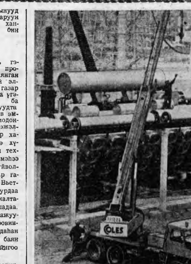
Венгри. Зайн гал дамжуулаха уласкоорондын линини барилга түлэг дундаа. Ажа дүү социалис оронудыне хоо-болон «ЛЭП-780» гэжэ линини барилгада хүдэлжэ бай-хан хүдэлмэришн горитой амжалта туулаба. ЗУРАГ ДЭЭРЭ: Альбертирма шадрин подстанци. ТАСС-ай фотохронико.
